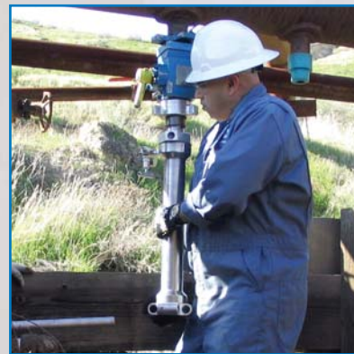
Operación de la válvula de servicio y el extractor en el campo
